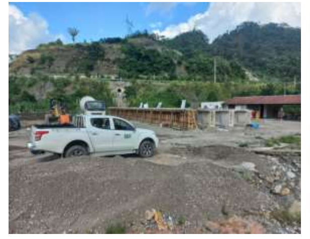
Construcción puente vehicular La Playa Central Yungas Espíritu Santo D10 - Municipio de Villa Tunari (CONVENIO FONADIN)
